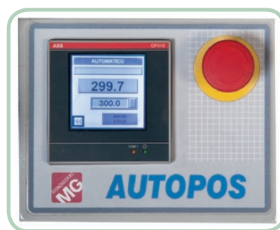
Cuadro de mandos. Control panel.
